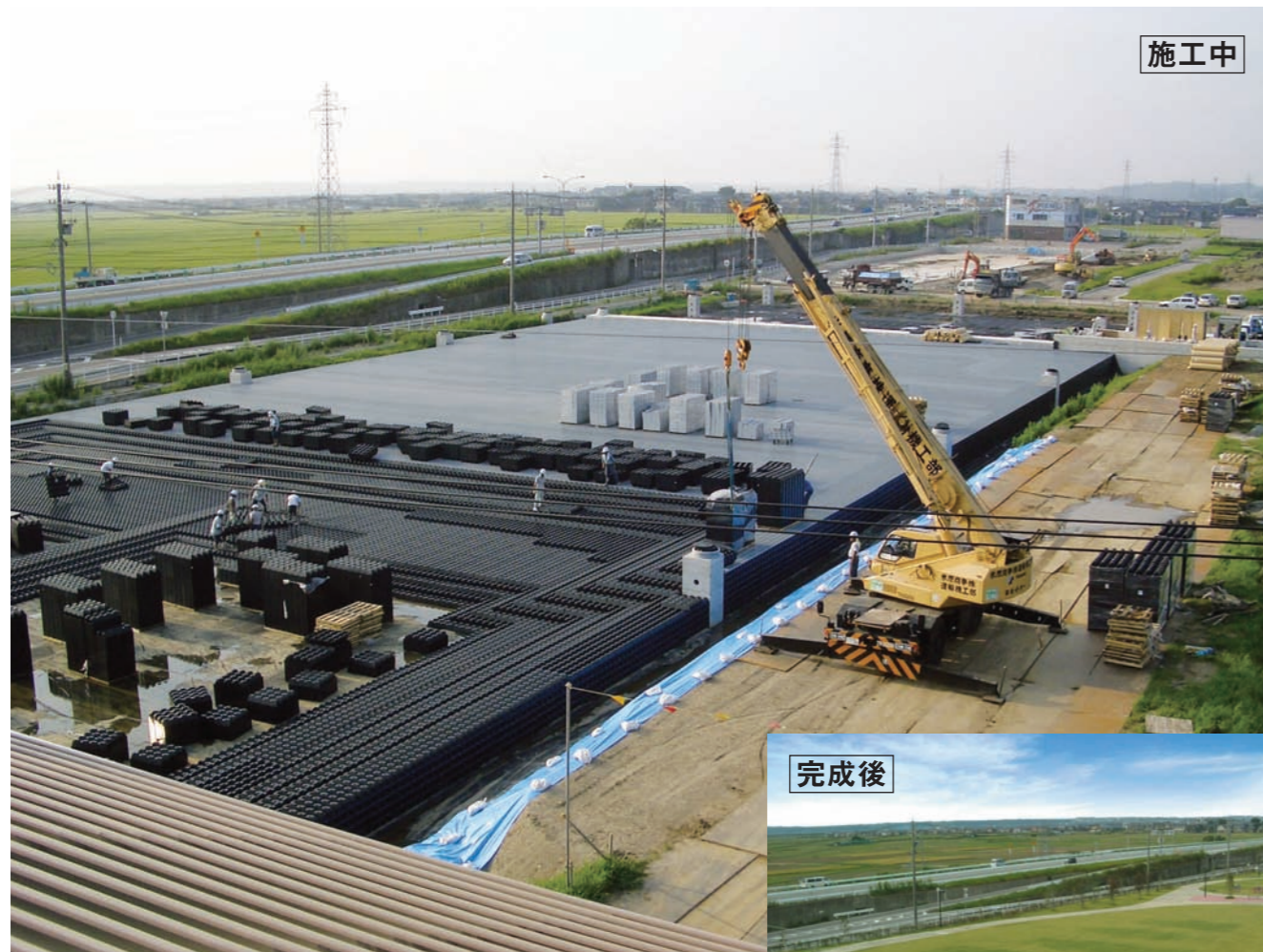
石川県内区画整理調整池 (貯水量: 9,200m 3 )
