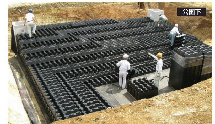
千葉県内宅地造成調整池 (貯水量: 420m 3 )
