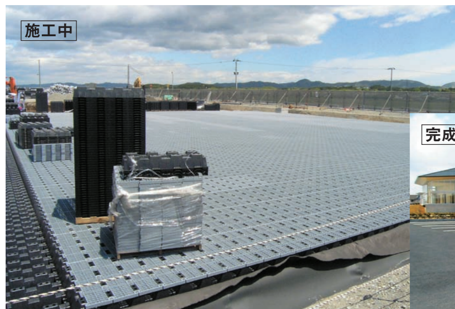
宮城県内庁舎調整池 (貯水量: 1,700m 3 )
